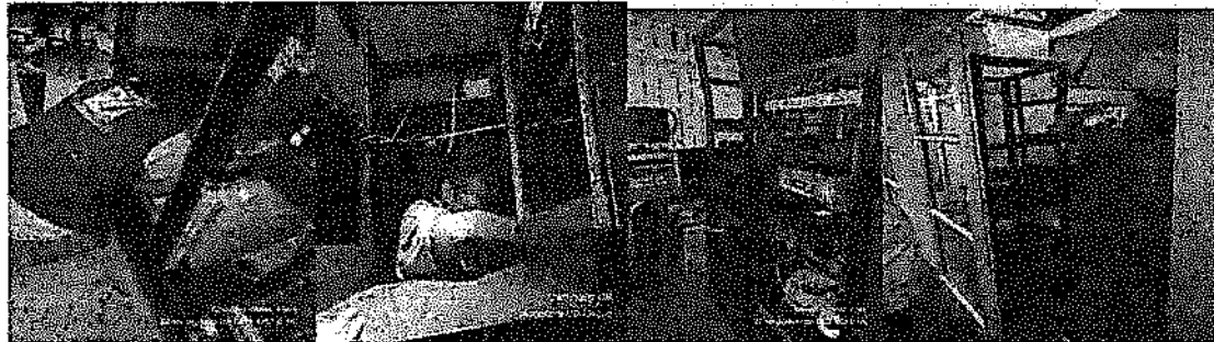
Se realiza movimiento y acomodo de rack del área de continuidad
